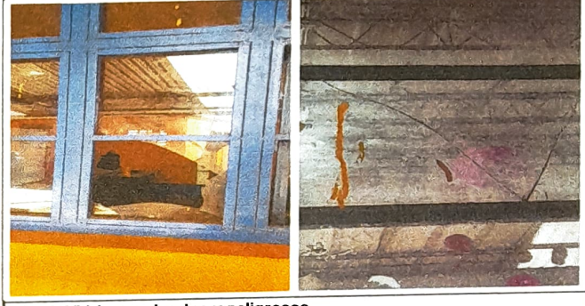
Foto 2: Vidrios quebrados y peligrosos
