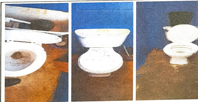
Foto 3: Inodoros en mal estado e incervibles
