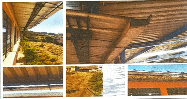
Foto 1: Caletas y soportes en mal estado
